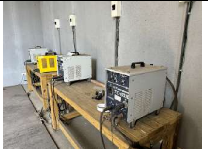
美術工坊焊接教室焊接設備
